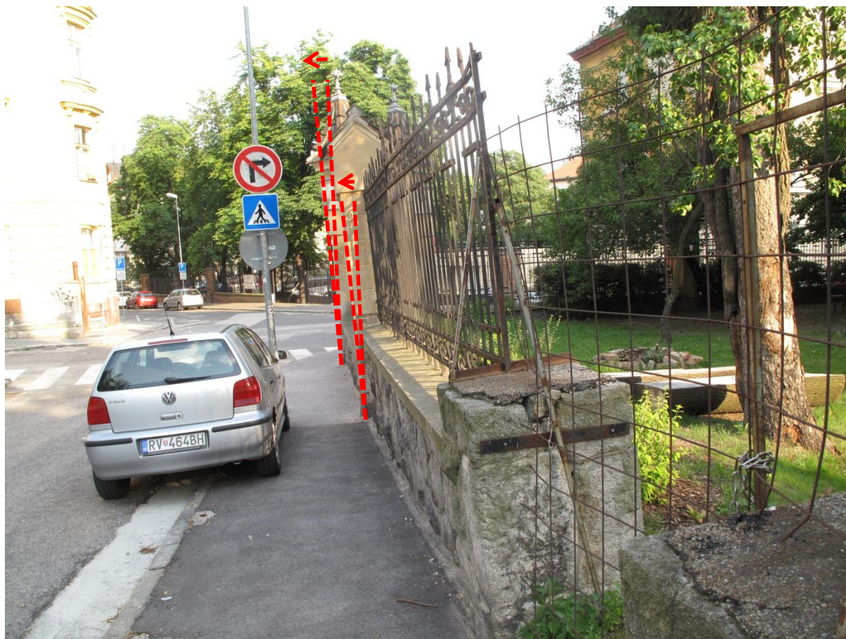
obr.08 Pohľad na deformovaný tvar stĺpa oplozenia a portálu
