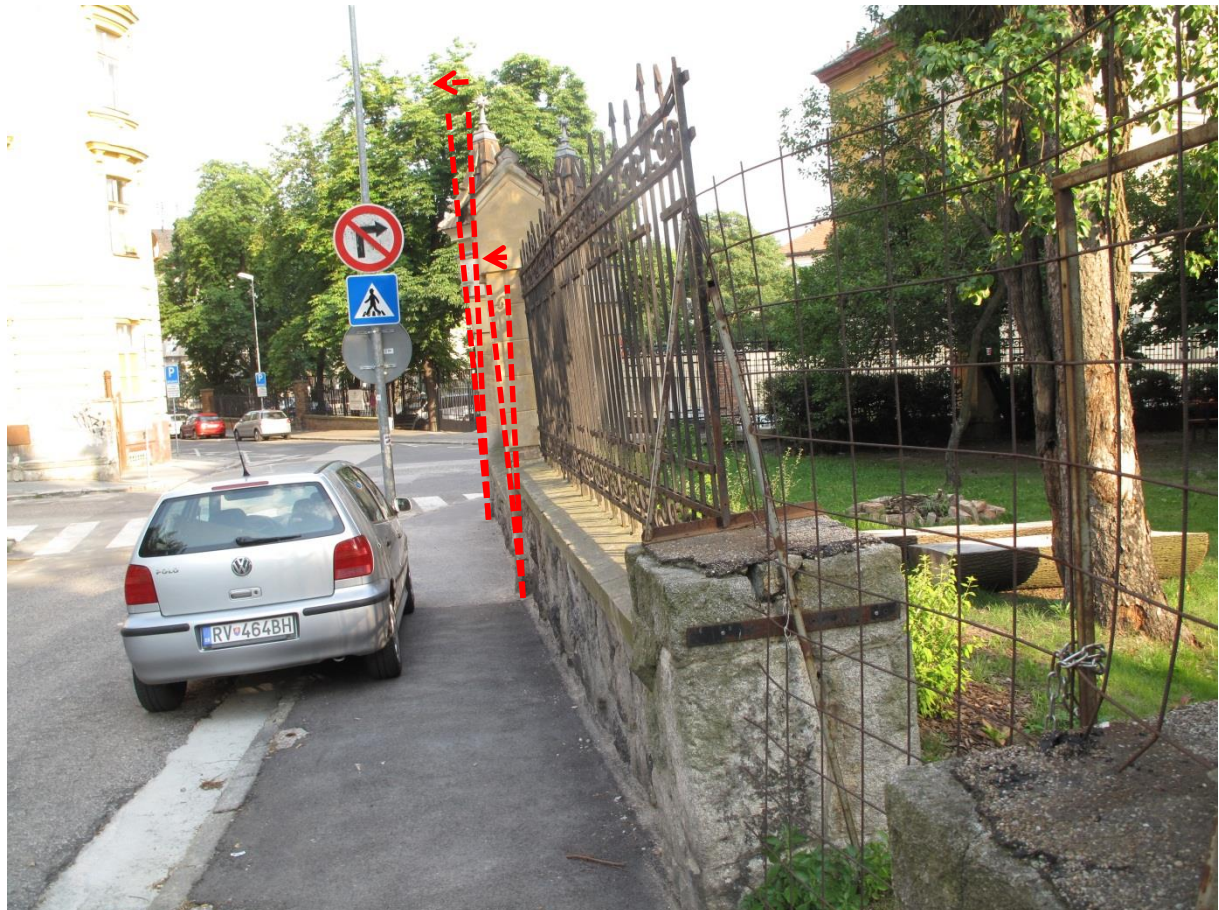
obr.08 Pohľad na deformovaný tvar stípa oplotenia a portálu
